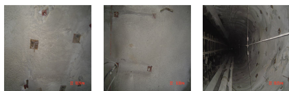
(a) 巷道顶部 (b) 巷道帮部 (c) 整个巷道
